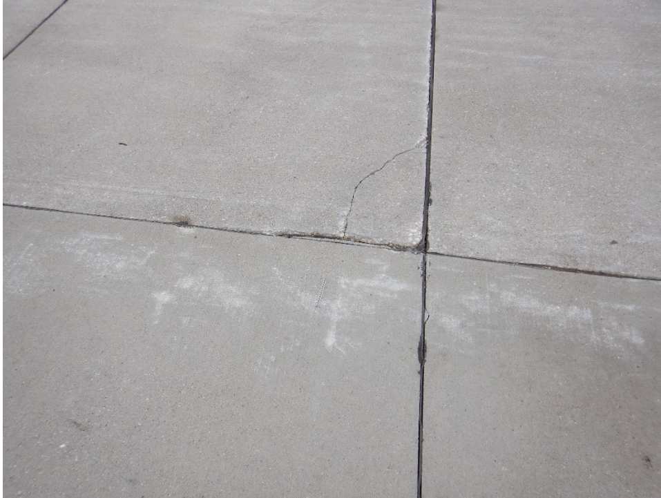
A01WC-03. Corner Break (Sample Unit No. 06).
