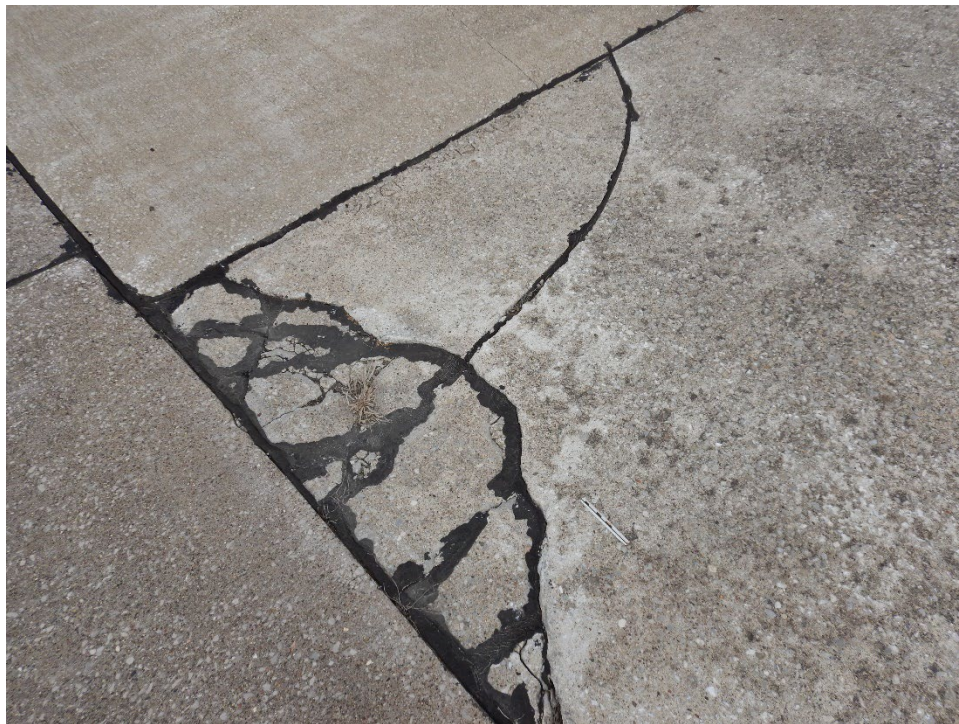
A01WA-05. Corner Break (Sample Unit No. 02).
