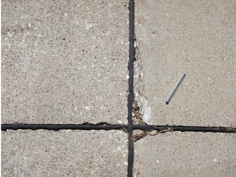
R17SL-02. Corner Spalling (Sample Unit No. 06).
