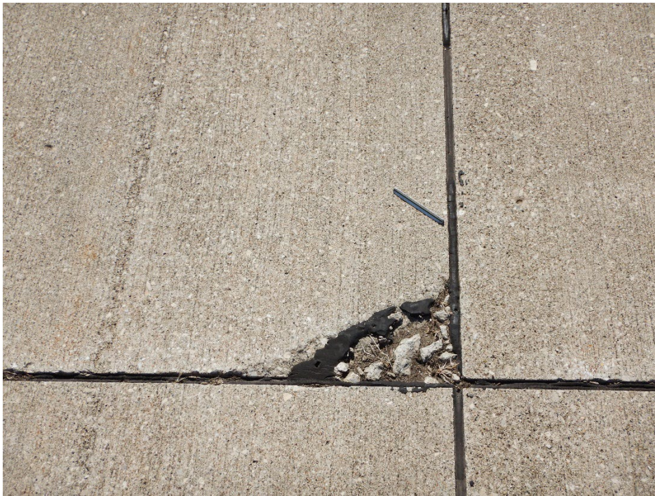
R17SL-01. Corner Spalling (Sample Unit No. 08).
