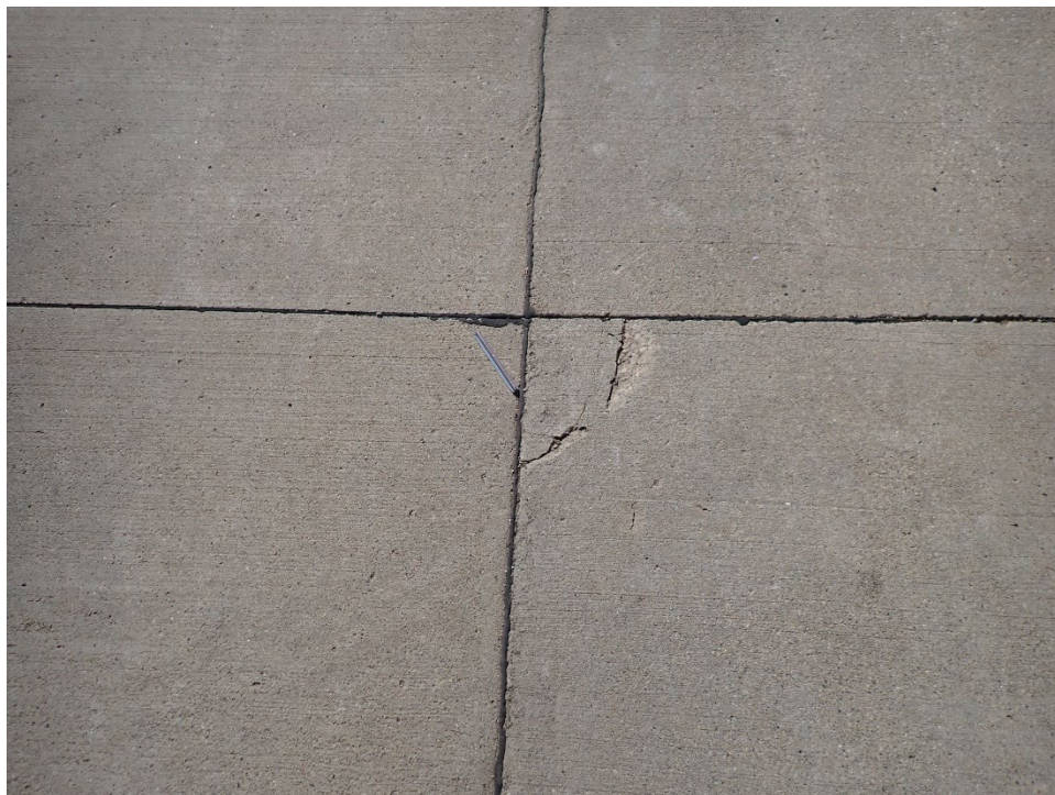
A01IS-01. Corner Spalling (Sample Unit No. 06).
