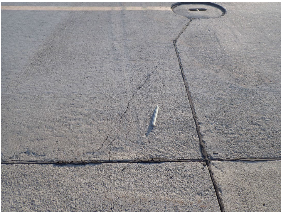
A01PE-05. Corner Break (Sample Unit No. 07).
