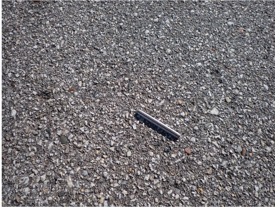
R171Y-03. Raveling (Sample Unit No. 03) (2).
