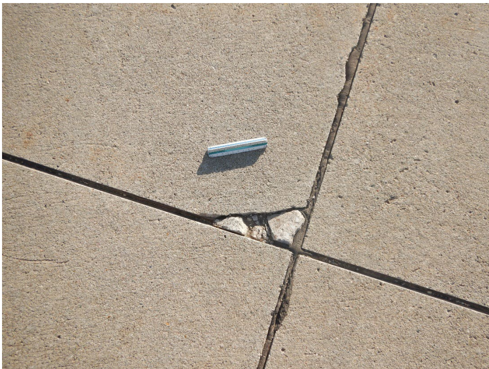
A010A-02. Corner Spalling (Sample Unit No. 06).
