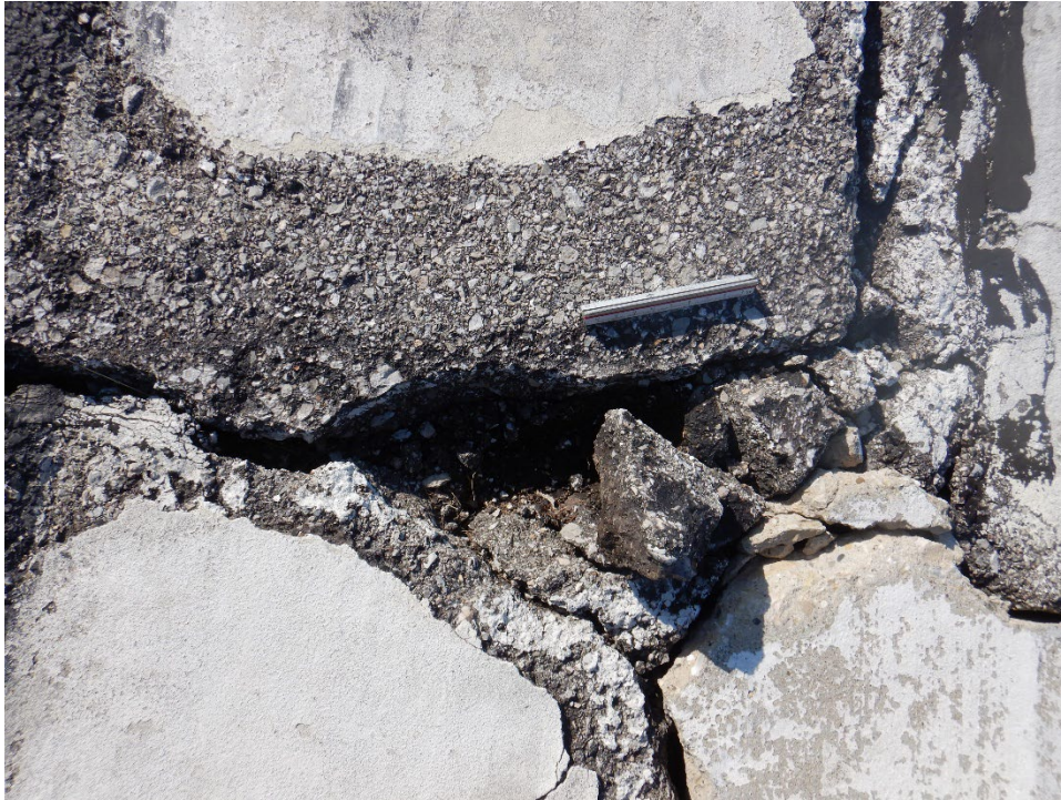
R17OS-01. Patching (Sample Unit No. 04) (2).
