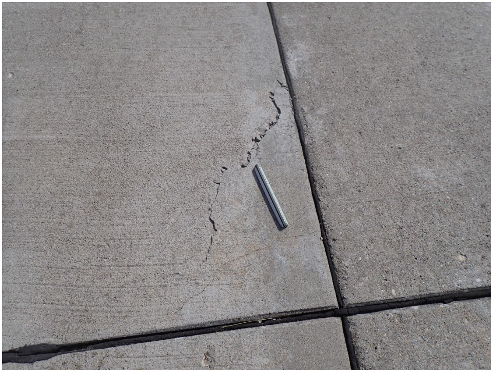
A03NE-03. Corner Spalling (Sample Unit No. 04).
