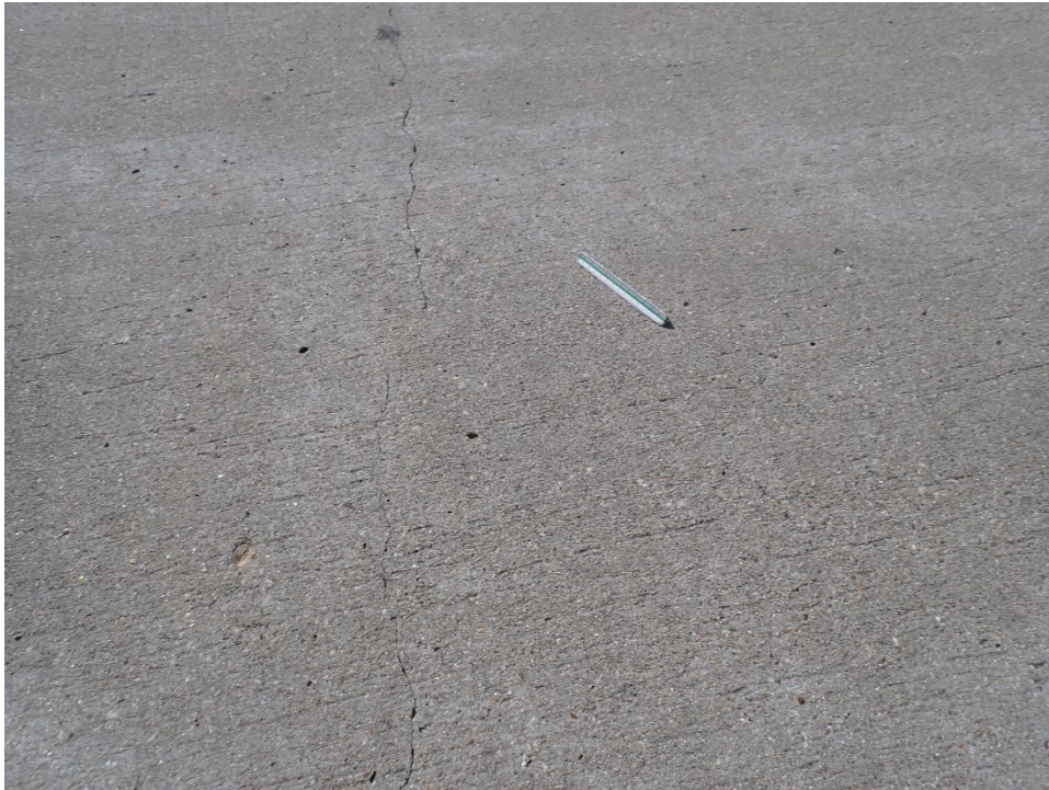
A03NE-01. LTD Cracking (Sample Unit No. 15).
