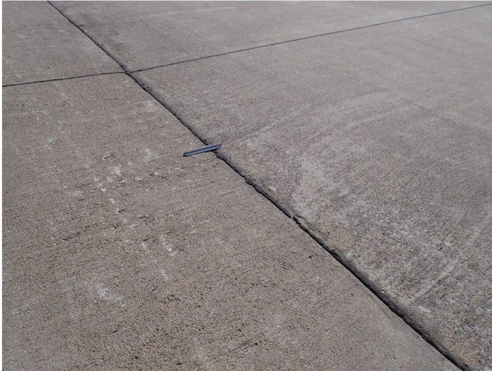
A03NE-02. Faulting (Sample Unit No. 06).
