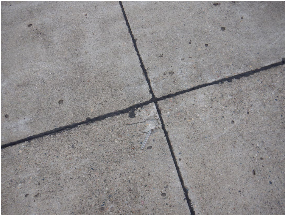
R18LE-03. Corner Spalling (Sample Unit No. 02).
