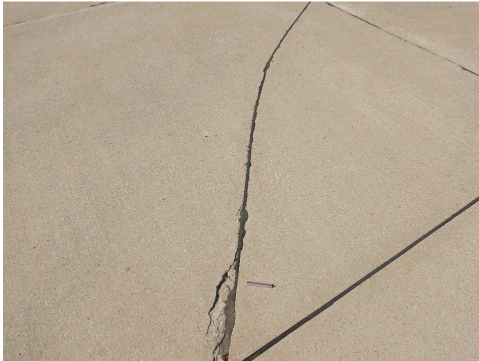
A01LA-01. LTD Cracking (Sample Unit No. 02).
