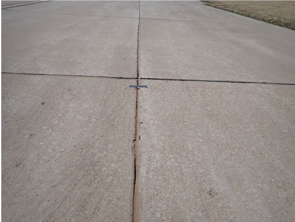
TBKN-03. Faulting (Sample Unit No. 02).
