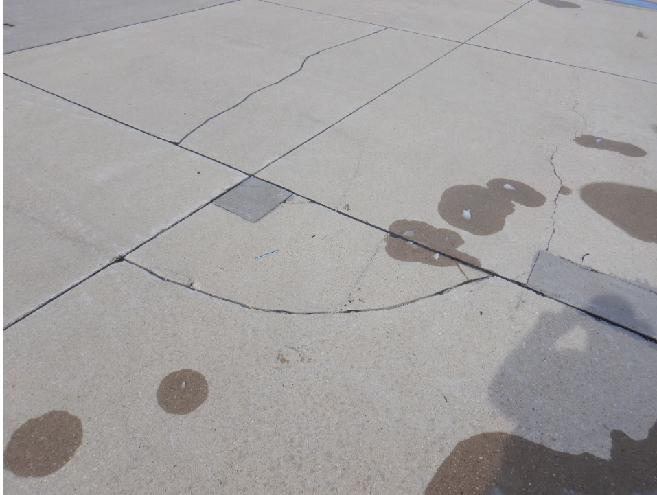
TH01IN-02. Corner Break (Sample Unit No. 02).
