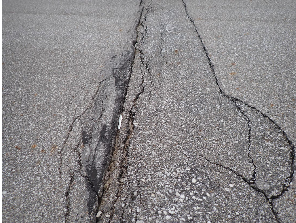
R12IG-03. Patching (Sample Unit No. 02).
