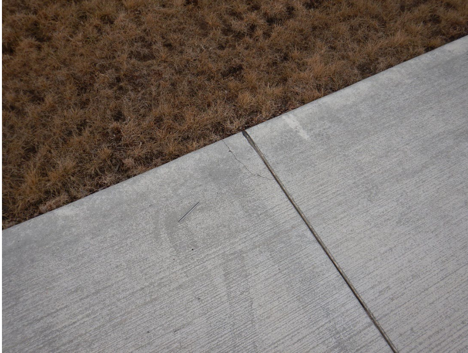
R12HU-01. Corner Spalling (Sample Unit No. 48).
