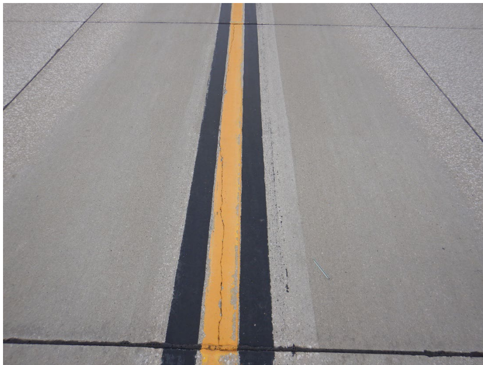
TDFD-03. LTD Cracking (Sample Unit No. 02).
