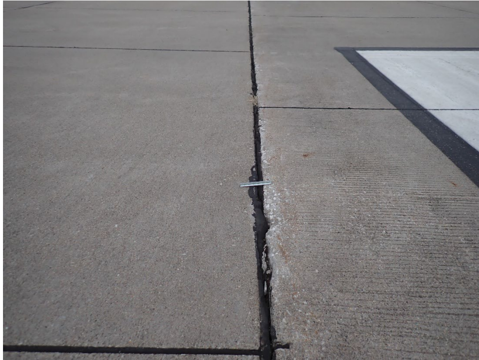
R12DN-05. Faulting (Sample Unit No. 02).
