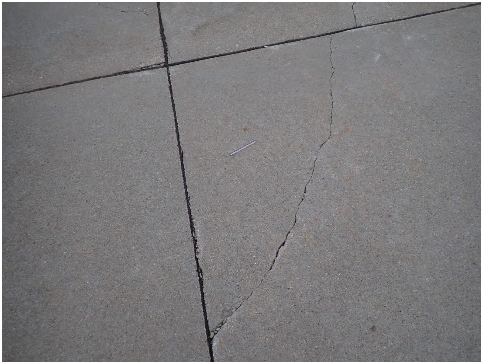
A01DN-01. Corner Break (Sample Unit No. 04).
