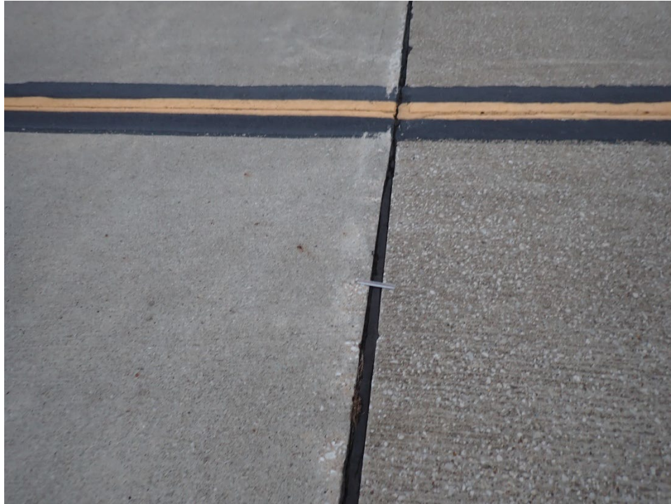
R12DN-03. Faulting (Sample Unit No. 01).
