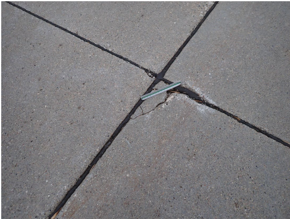
TH01DN-03. Corner Spalling (Sample Unit No. 03).
