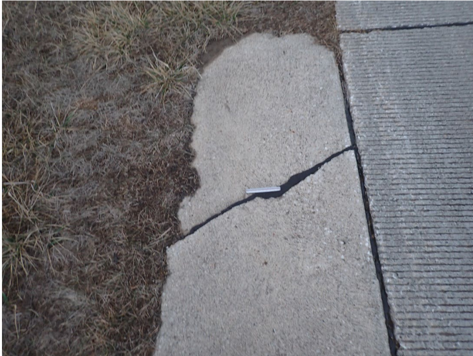
R12DN-06. LTD Cracking (Sample Unit No. 02).
