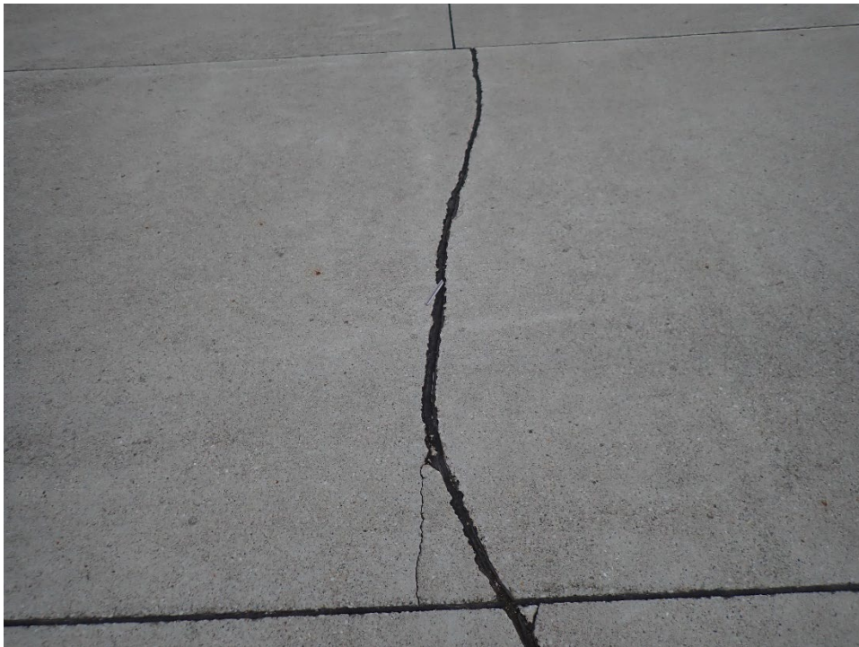
R12DN-07. LTD Cracking (Sample Unit No. 01).
