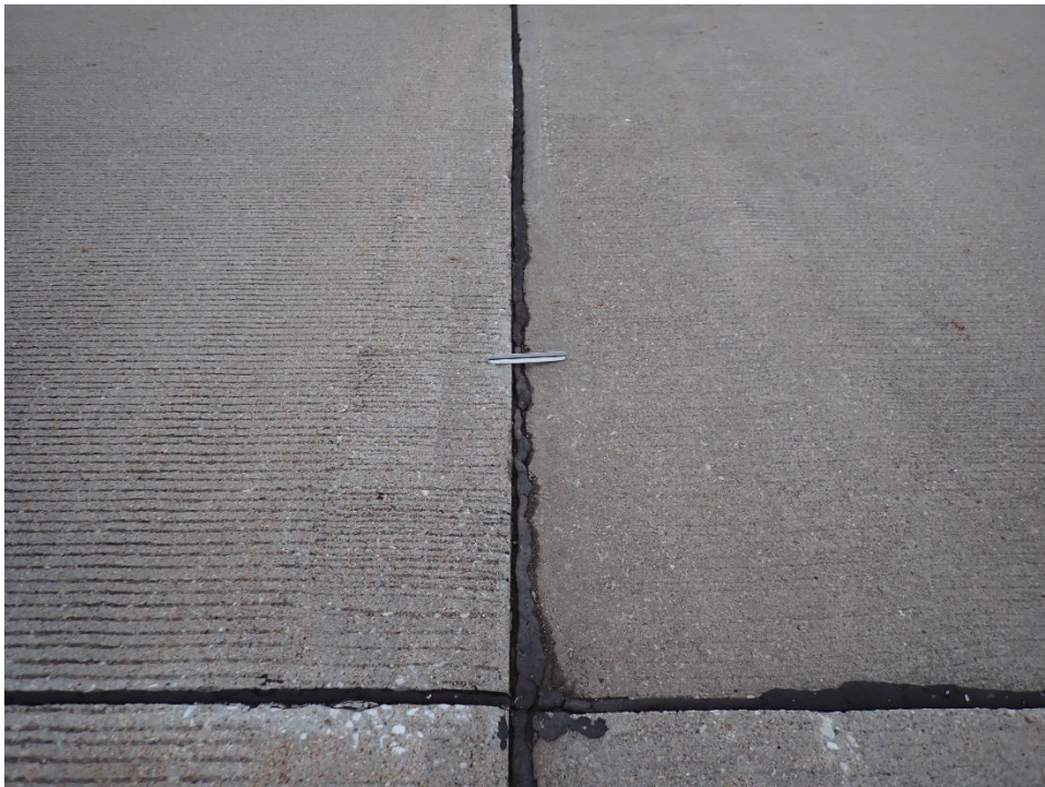
R12DN-02. Faulting (Sample Unit No. 02).
