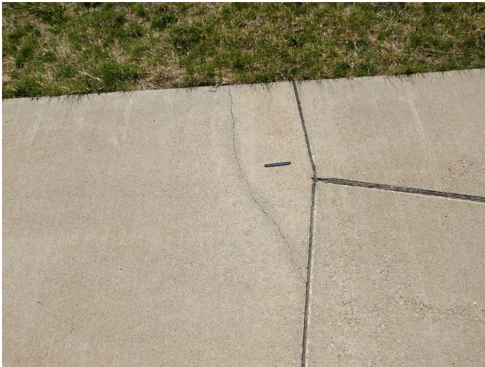
TADA-05. Corner Break (Sample Unit No. 08).
