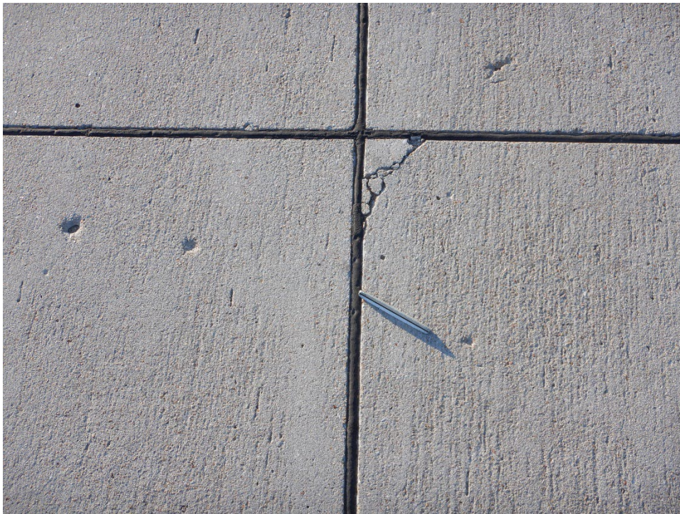
A01CB-01. Corner Spalling (Sample Unit No. 08).
