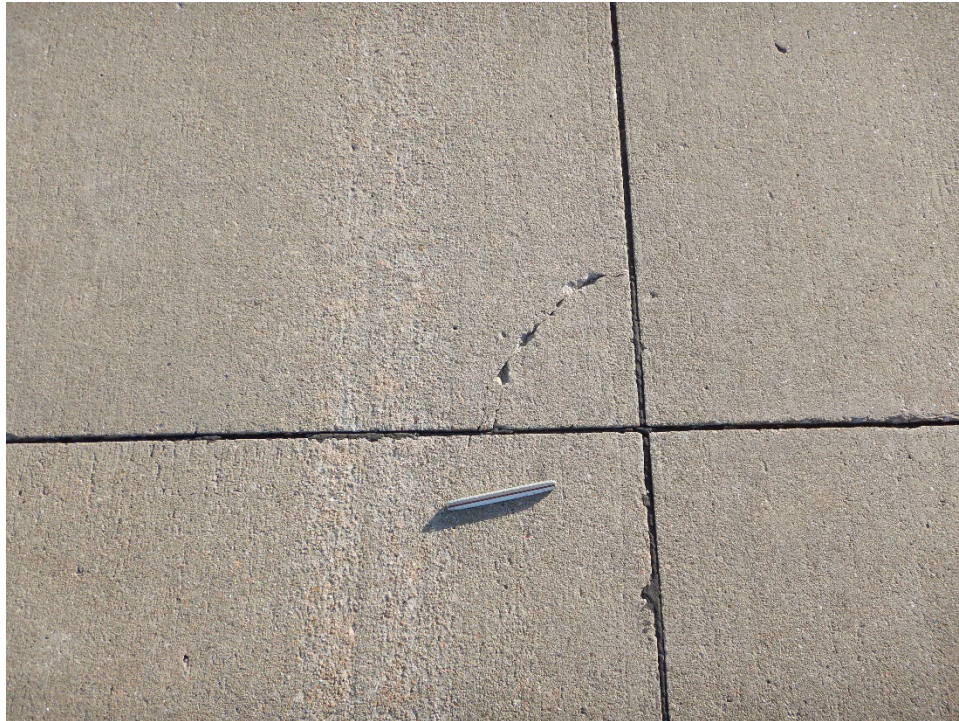
TH01CB-01. Corner Spalling (Sample Unit No. 03).
