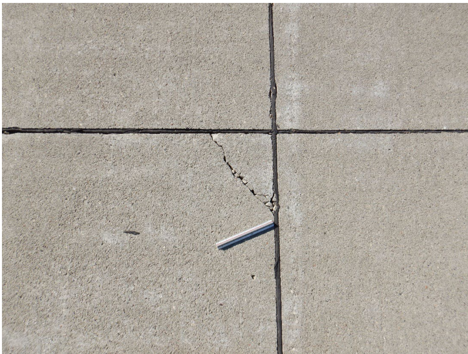
A01CN-04. Corner Spalling (Sample Unit No. 01).
