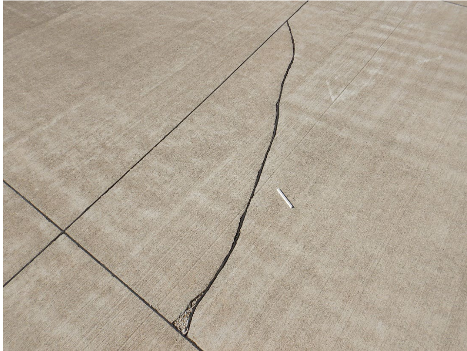
TBCN-01. LTD Cracking (Sample Unit No. 06).
