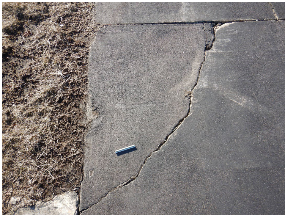
A02CN-01. Corner Break (Sample Unit No. 01).
