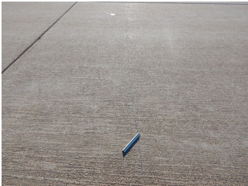
R03CN-01. LTD Cracking (Sample Unit No. 64).
