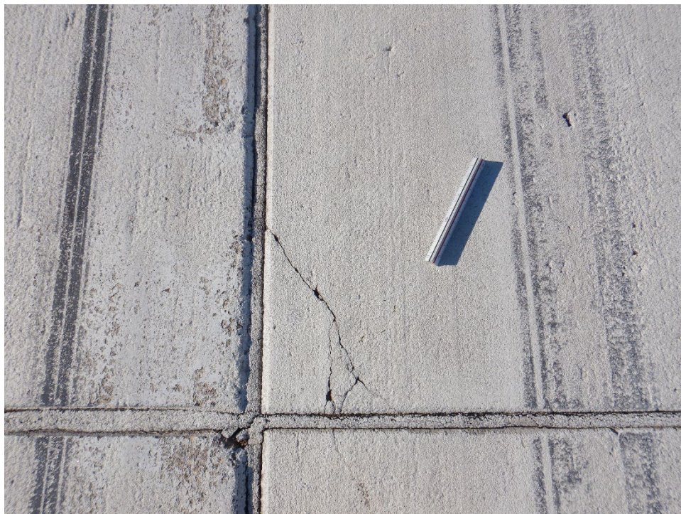
R03CN-01. Corner Spalling (Sample Unit No. 113).
