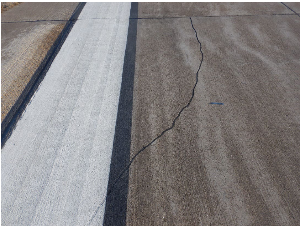
R03CN-02. LTD Cracking (Sample Unit No. 07).
