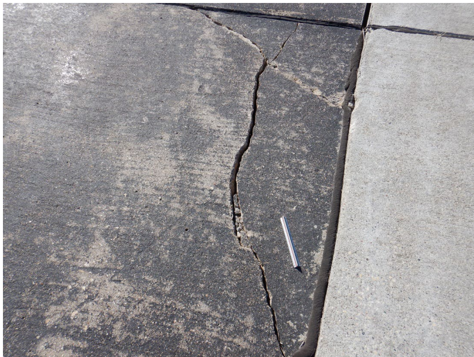
A01CN-01. Corner Break (Sample Unit No. 08).
