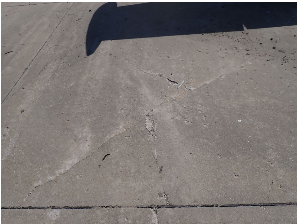
A01AN-01. Shattered Slab (Sample Unit No. 36) (2).
