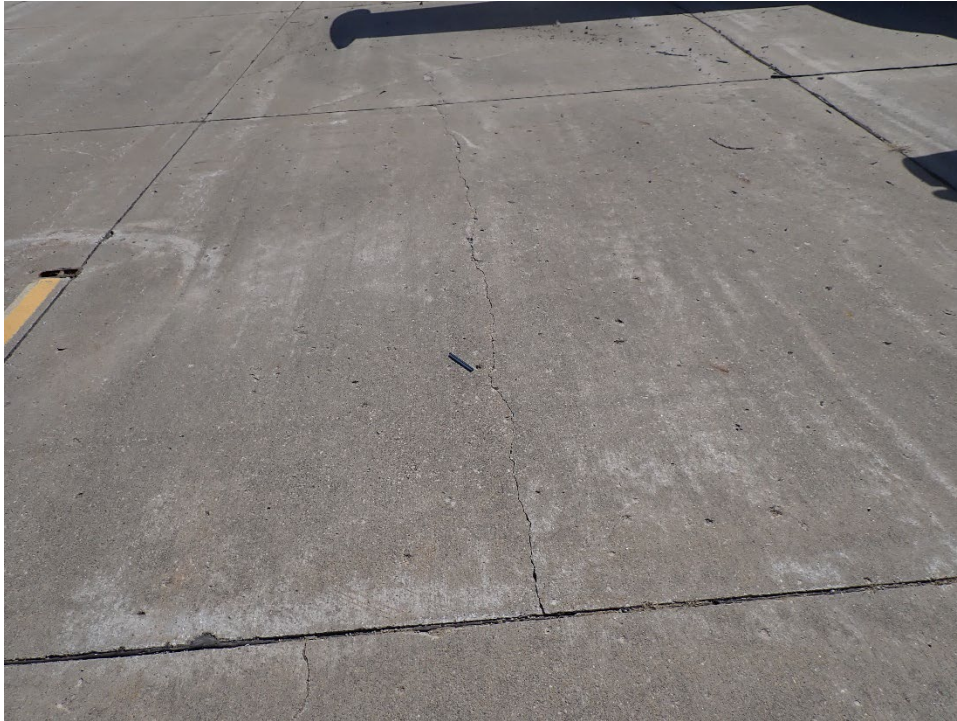
A01AN-01. LTD Cracking (Sample Unit No. 36).
