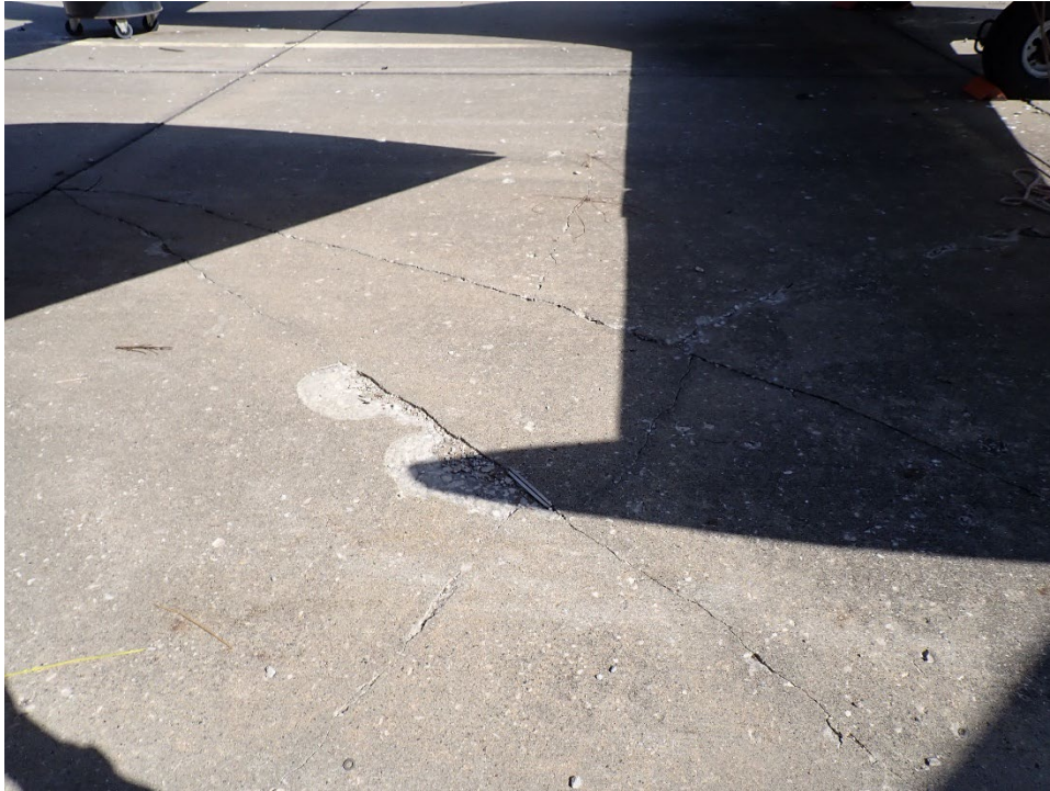
A01AN-01. Shattered Slab (Sample Unit No. 36) (1).
