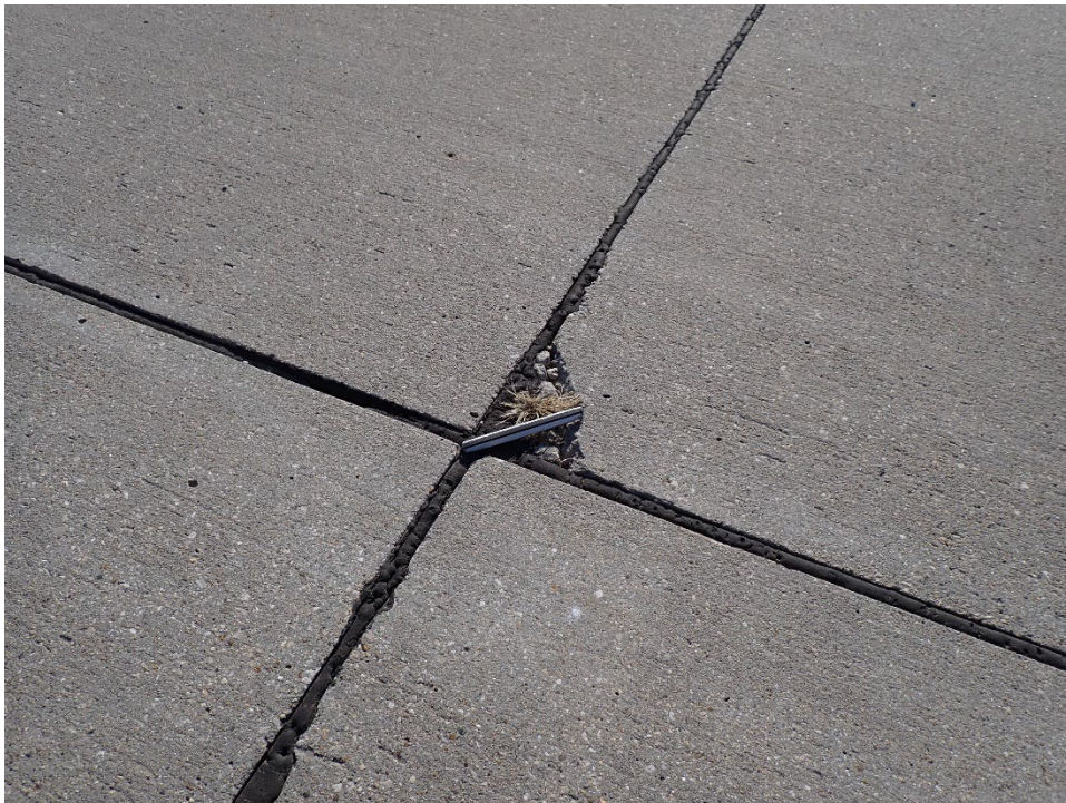
T12AN-01. Corner Spalling (Sample Unit No. 06).
