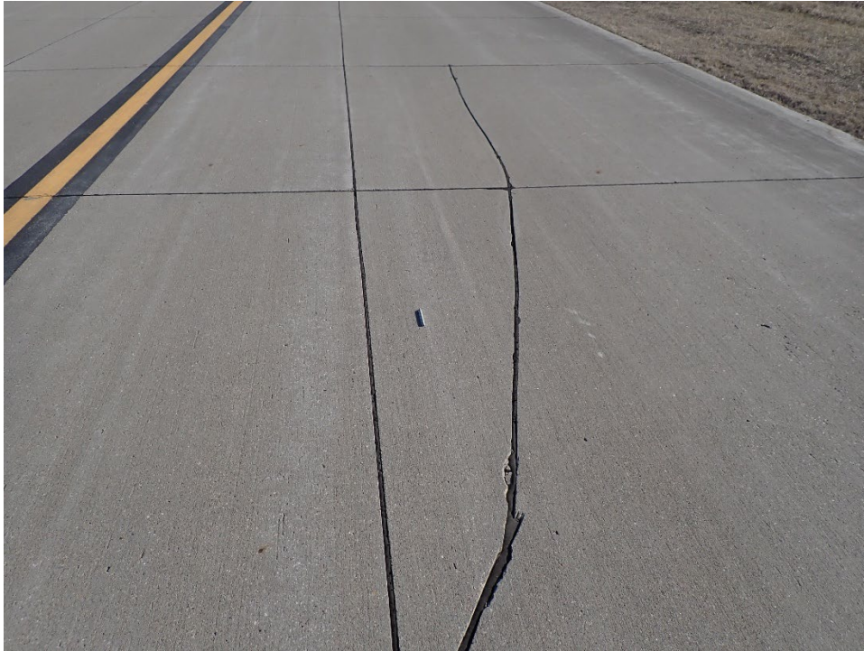
T12AN-01. LTD Cracking (Sample Unit No. 06).
