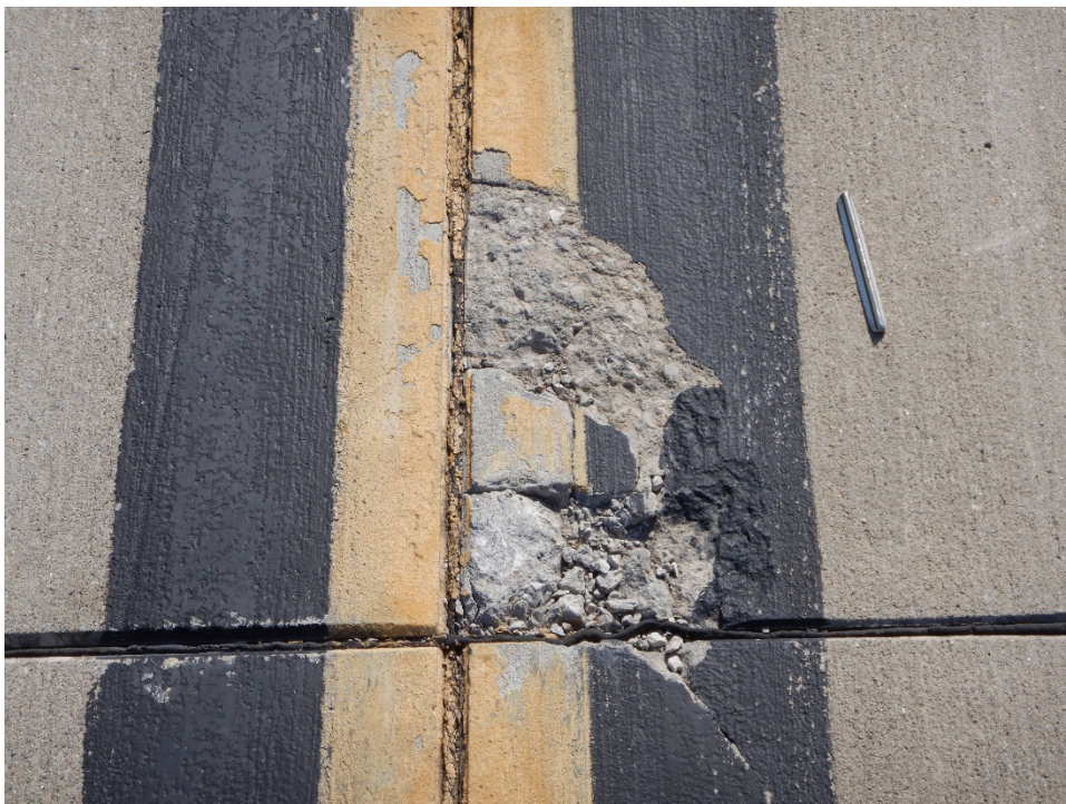
TA1AM-01. Corner Spalling (Sample Unit No. 06).
