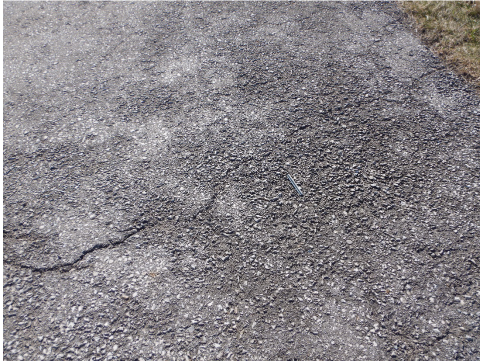
TAAM-03. Raveling (Sample Unit No. 01).
