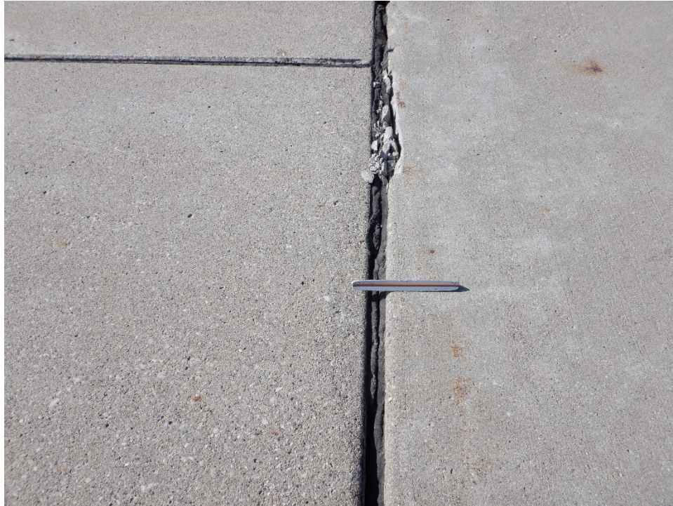
TB1AM-03. Faulting (Sample Unit No. 02).
