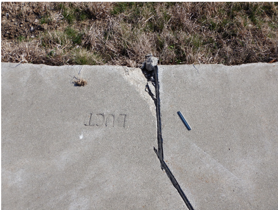
TB1AM-03. Corner Spalling (Sample Unit No. 02).
