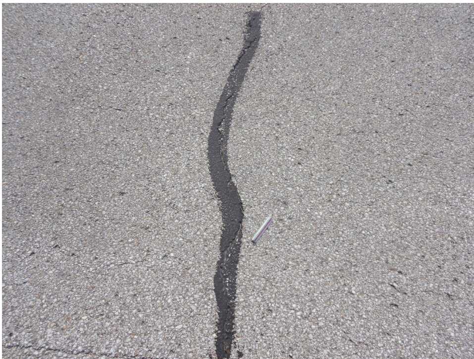
R13AL-03. L&T Cracking (Sample Unit No. 08).
